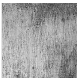
3. 白錆が出てしばらく経った状態
